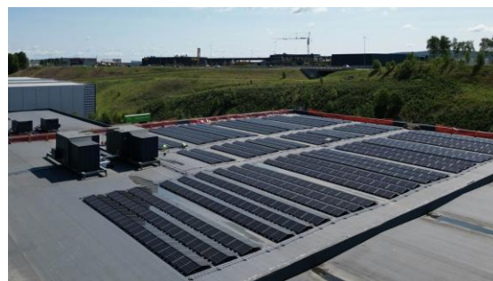
Solceller Gneisveien 18. (Foto: Storebrand arkiv)
