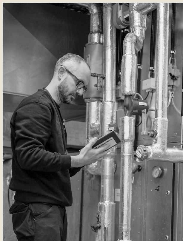
Grev Wedels plass 9, Oslo. Driftstekniker i arbeid på bygget. Foto: Storebrands arkiv
